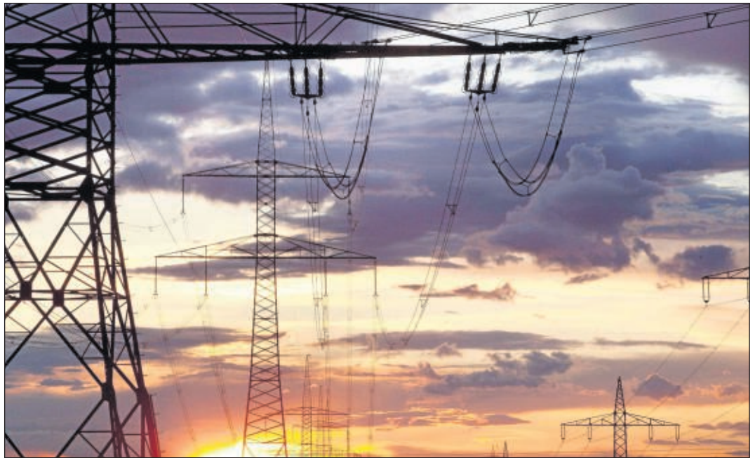
Höchstspannungstrasse: 380-Volt-Leitungen sollen den Strom von Wahle in Niedersachsen nach Mecklar in Nordhessen transportieren.
